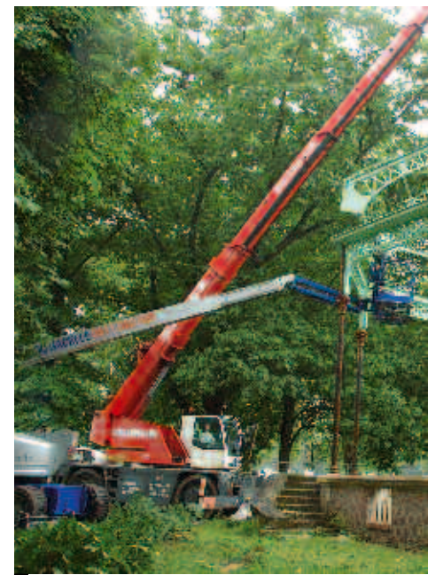
LA COUPOLE DU KIOSQUE PÈSE ENVIRO REMONTÉE AU SOL PUIS HISSÉE AU SOM BRAS TÉLESCOPIQUE
